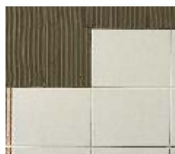
Płytki ułożone na ścianie. Szczeliny między płytkami wolne od kleju.
